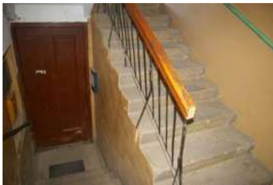
Būve ar kadastra apzīmējumu 6415 002 0064 001, koplietošanas telpa
